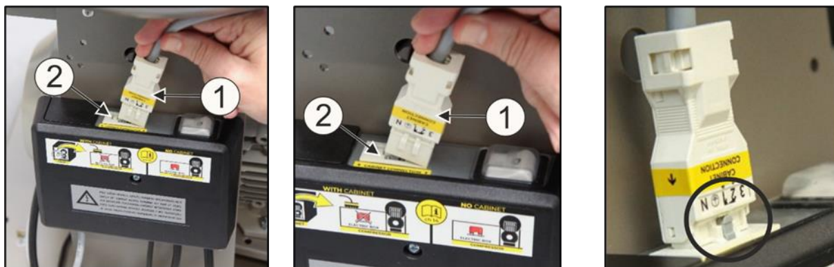
Рис. 11: Подключение шкафа к компрессору
